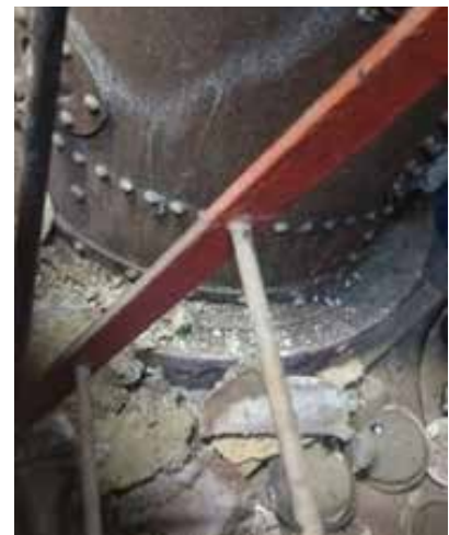
Figuur 3: Beskadigde hittepomp.
